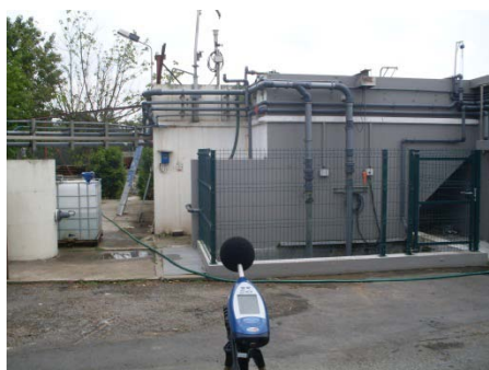
Fotografia 4.22 – Zona de tratamento de águas
