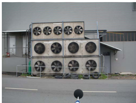
Fotografia 4.19 – Equipamento de refrigeração em funcionamento atualmente
