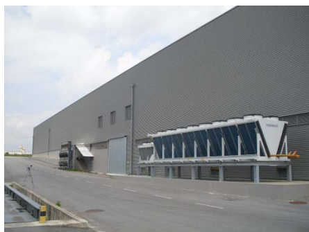
Fotografia 4.20 – Equipamento de refrigeração em funcionamento atualmente
