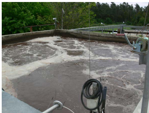
Fotografia 3.13 – Tanque de arejamento (lamas ativadas)
